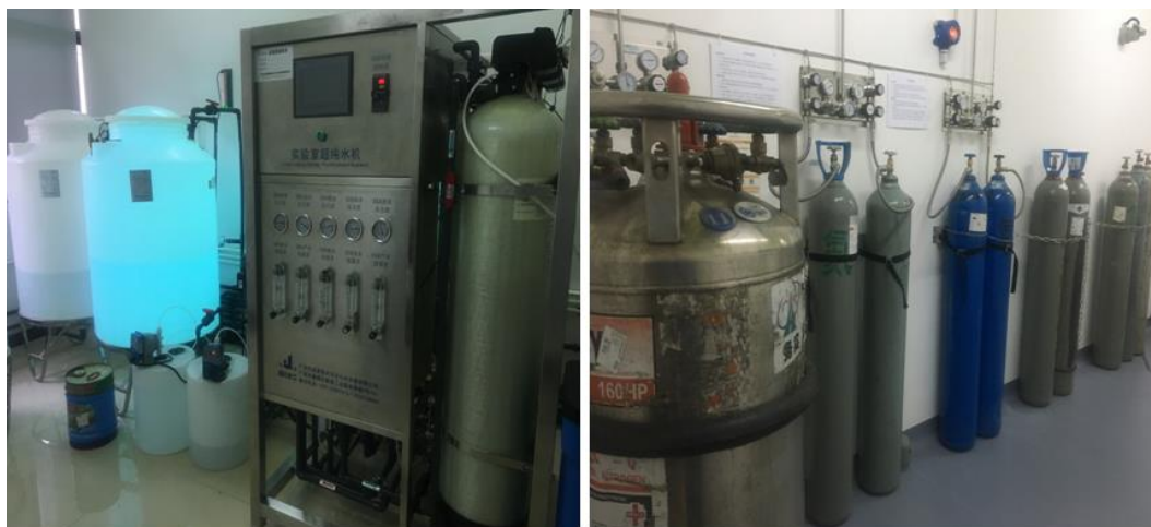
纯水系统和集中供气系统
