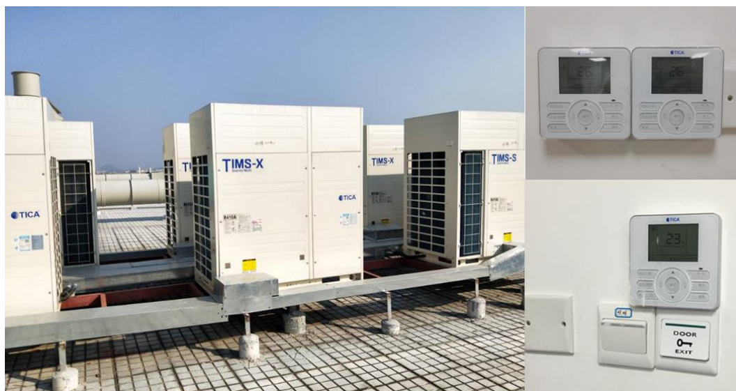
中央空调系统
